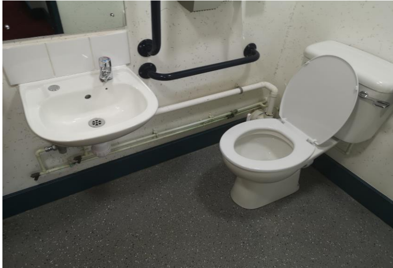
Disabled Toilet TMV
